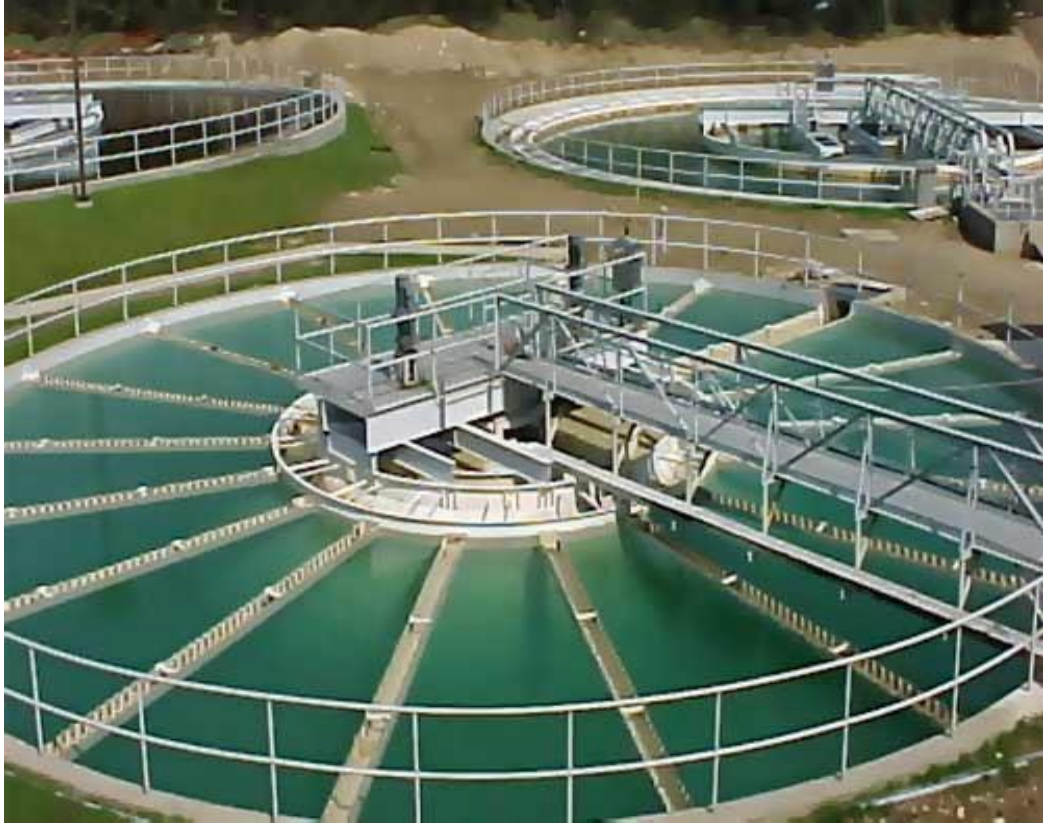
شكل (6-7) أحواض التجميع أو أحواض الأكسدة .
